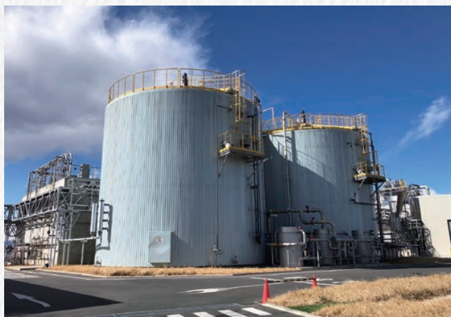
コープデリ連合会が出資するバイオガス発電施設「ニューエナジーふじみ野」
